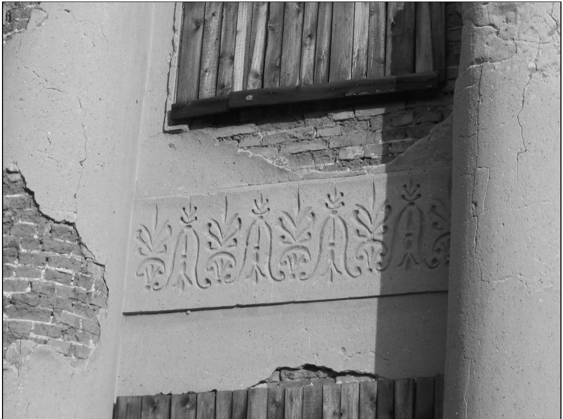
Il. 12. Pozostałość fryzu międzyokiennego fasady-stan obecny
