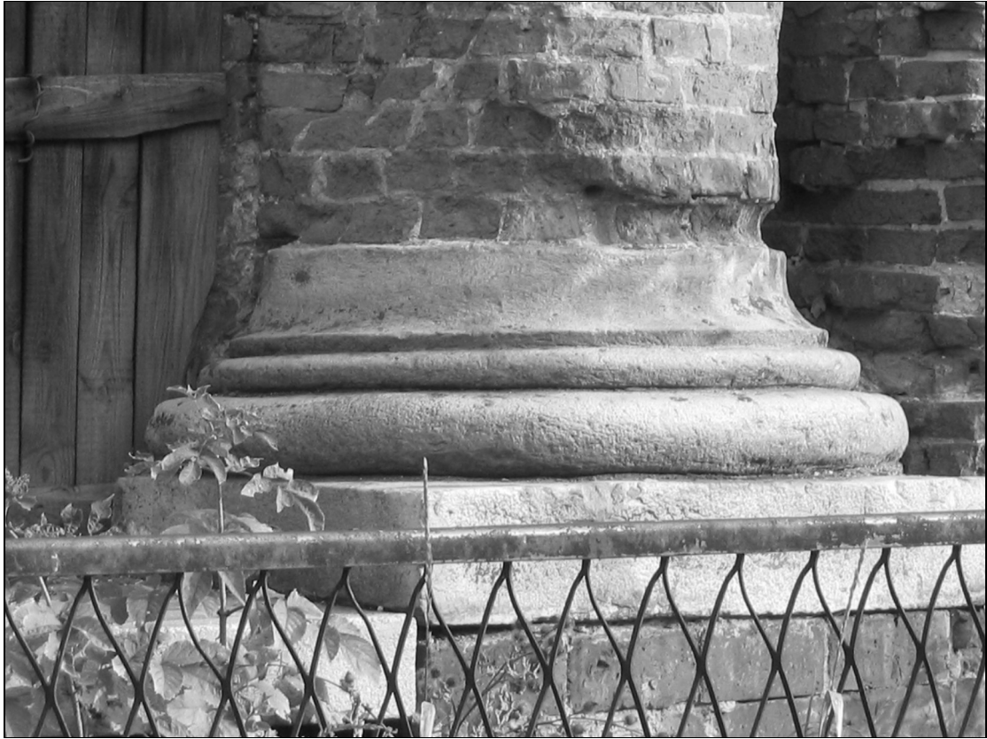
Il. 11. Baza półkolumny portyku-stan obecny
