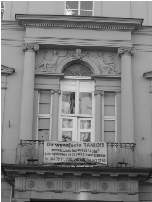
Il. 53. Fragment fasady kamienicy przy ul. Wita Stwosza 16 we Wrocławiu -stan obecny.
